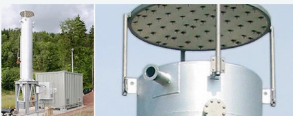
Degazificarea depozitului sanitar
