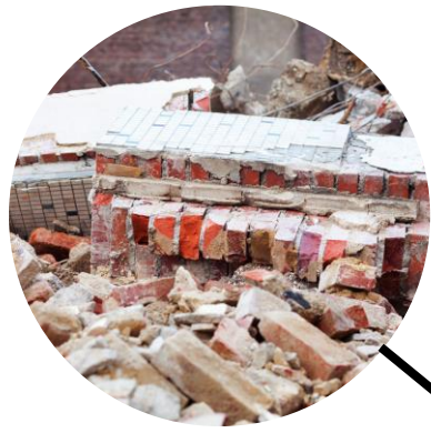
Deșeuri de construcții
